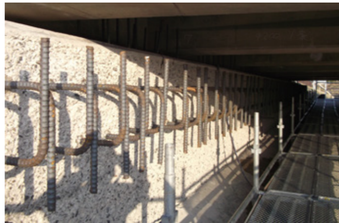
【縁端拡幅工事】 地震時に橋桁が落下するのを防ぐために、桁がかり部分を拡幅する工法。接着系アンカーを使用する。
